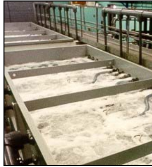
Figura 8, Vista superior de un tanque con membranas sumergidas, se ve una elevada agitación
